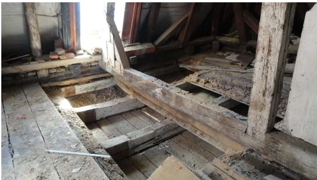
Odkrywką stropu – widoczny pas dolny więzara dachowego oraz belki stropowe. Widoczne pęknięcia podłużne belki 2. W głębi widoczne warstwy stropu (polepa)
