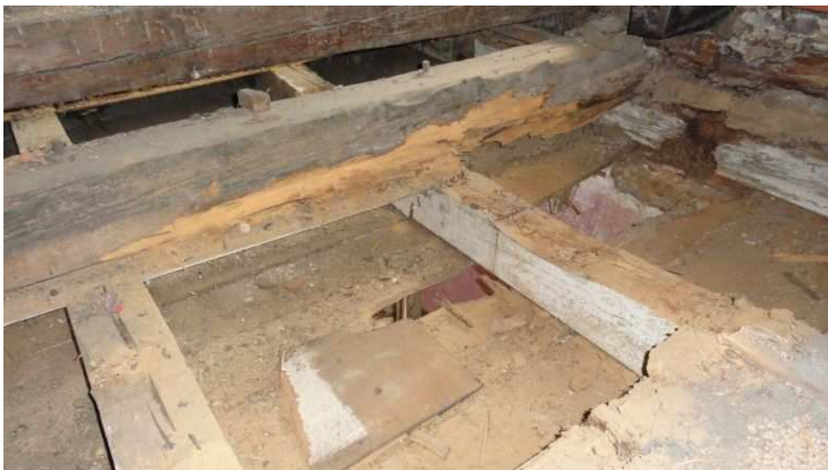
Odkrywka – widoczny podciąg 22*27 cm, zmurszały na odcinku od ściany do belki nr 2. Widoczne zmurszałe murłaty M1 i M2.
