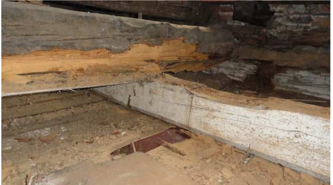
Pęknięcie belki nr 1, w miejscu podwieszenia do podciągu
