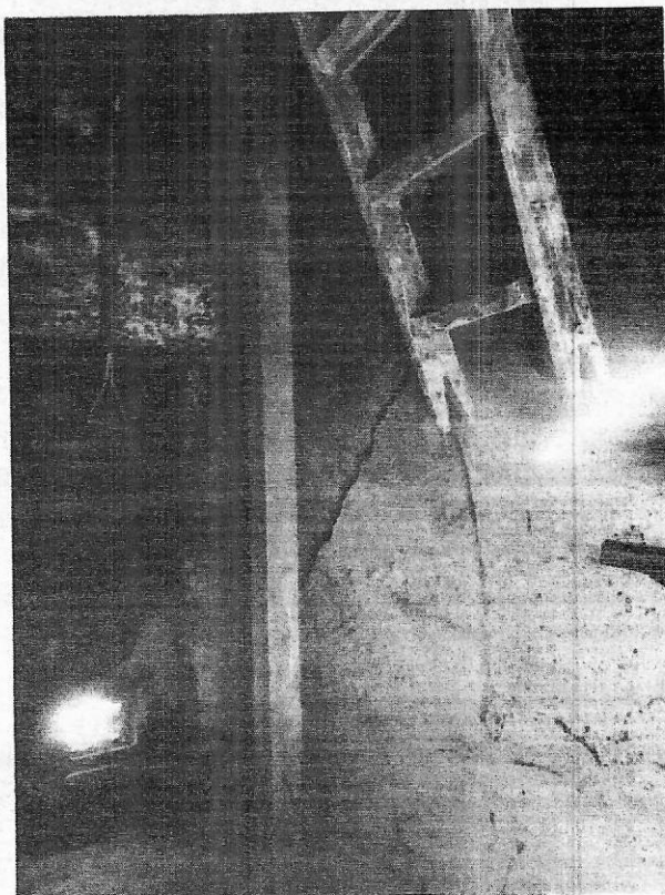
Pęknięcia ścian parteru – do wzmocnienia prętami spiralnymi
